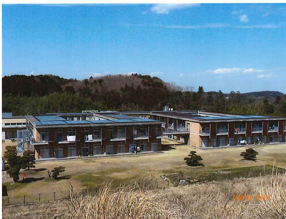
(溪泉荘 A 棟・B 棟屋根に設置したソーラーパネル)
